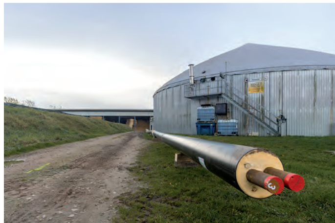
Abbildung: Wärmenetzrohre bei der Biogasanlage von Jan Thormählen
