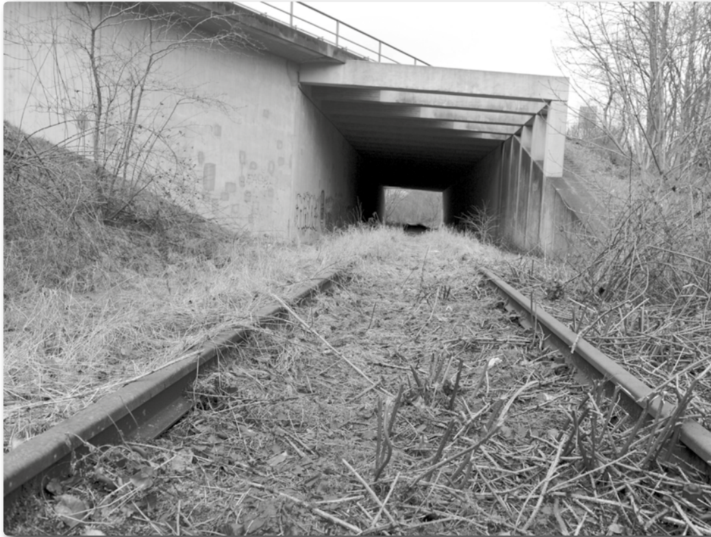
Am Autobahntunnel: Strecke im maroden Zustand
